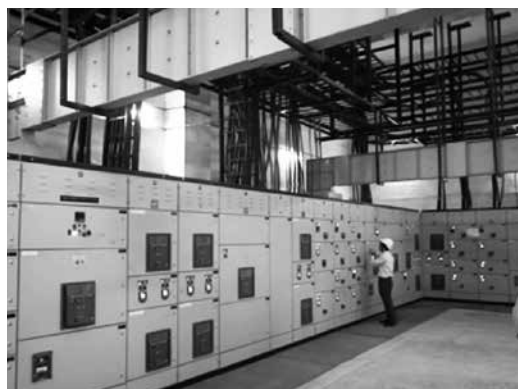
電気室内部 非常に広い
