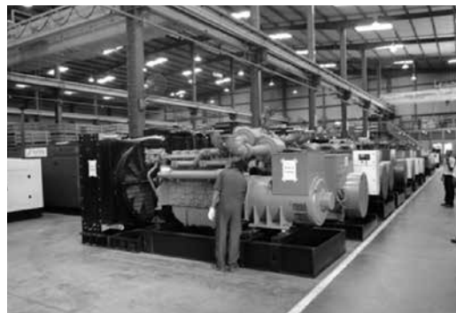
製造中の発電機
