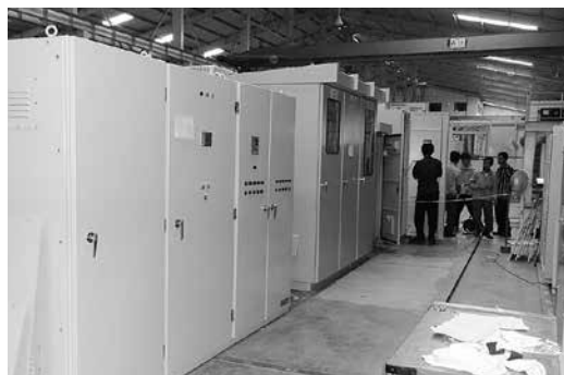
PT. Uni Makmur Elektriika 配電盤検査場
