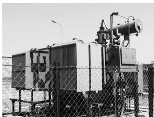
屋外設置の変圧器
